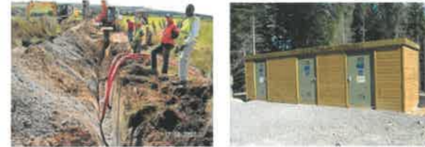
Figure 18: Déroulage et pose des câbles (à gauche), exemple de poste de livraison (à droite) (Source : EDF Renouvelables)
